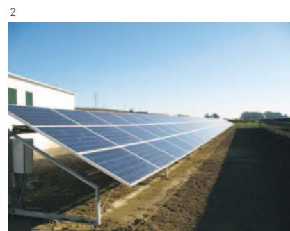
1 Installations sur toit de 217 kW à Valle Hermoso, dans l'agglomération de Séville.
